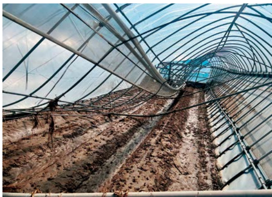
令和6年台風10号の強風で大きく傾いたハウス
