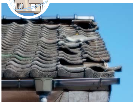
台風で、屋根瓦が破損、室内には雨漏りが発生しました。
