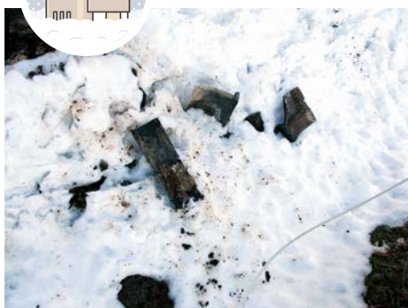
雪の重みにより屋根瓦が破損、落下しました。
